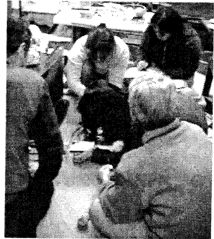
断線していたケーブルと継ぎ合わせるケーブルの確認が始まり、メモ係りと懐中電灯を利用してケーブル色とピンの伝導確認が中辻氏指導のもとで彼女たち三人で始まった。
